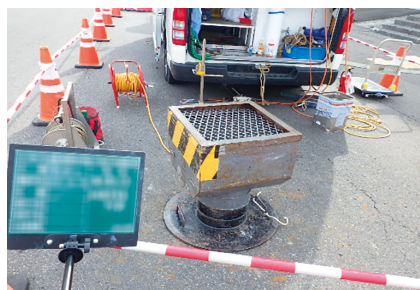
脱臭装置による臭気対策
