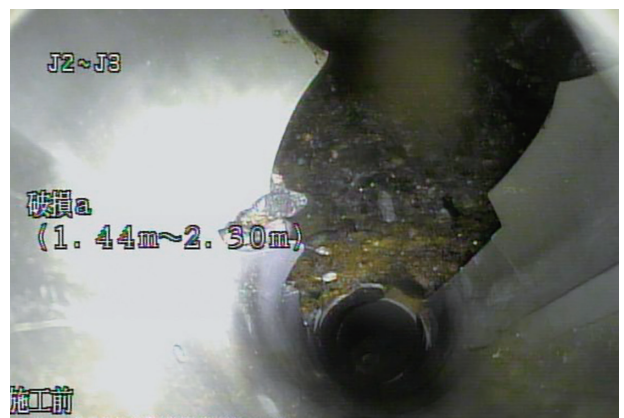
写真8 破損状況拡大
