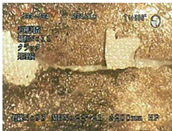
第3回 切り取り調査より クラック部
