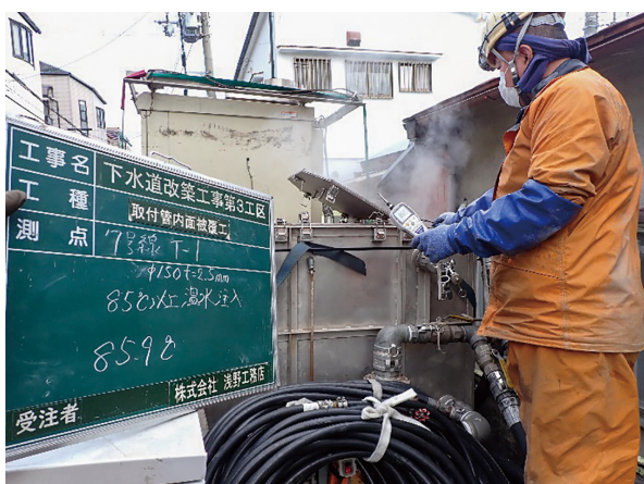
写真4 温水温度管理状況
