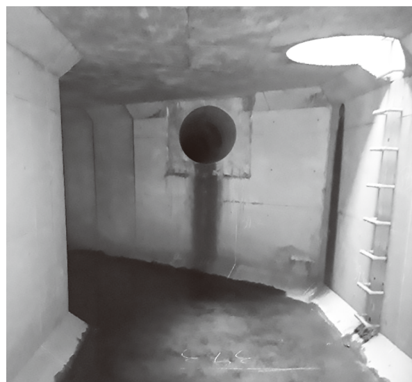
写真1 屈曲部の更生前状況
