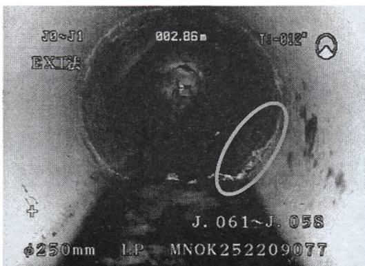
端部の不良 (樹脂不足)
