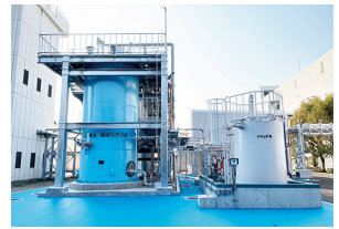
図2 リン回収施設
