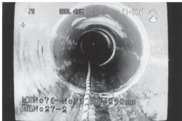
老朽管の状況
