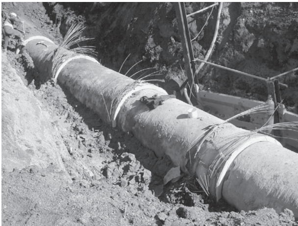
写真1 老朽管（PC管）の劣化状況
