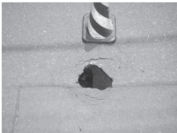
道路陥没の事例
